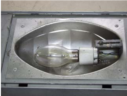
Luminaire ancien sans vasque
