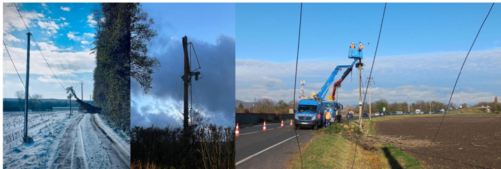
Photos des dégâts causés sur le réseau électrique
